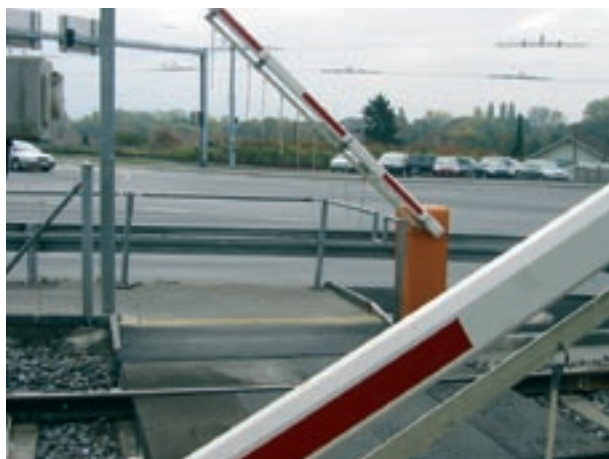
Lausanne : système de priorisation du trafic (barrières automatiques) – Source : Jean-Louis Jon
