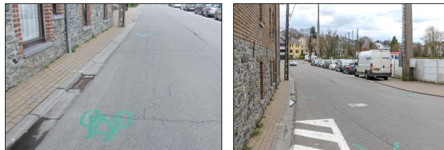
Photo 1 : Trottoirs étroit et poteaux entravant la circulation piétonne
